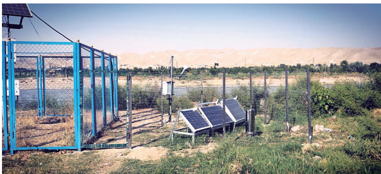
图4 塔菲尼甘水文站供电系统、北斗通讯设备、及雨量监测
